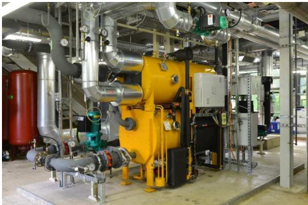
Absorptionskälteanlage im Kongresszentrum Hannover © TU-Berlin/ S. Petersen
