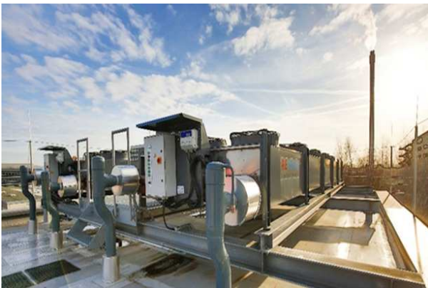
Rückkühlwerke im Rechenzentrum Hamburg © Vattelfall Europe
