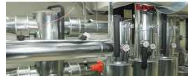
Kältezentrale in Berlin-Adlershof © TU Berlin/A. Hanßke
